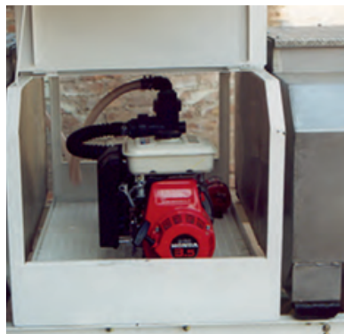
Alojamiento Motobomba Motor Pumps Box
