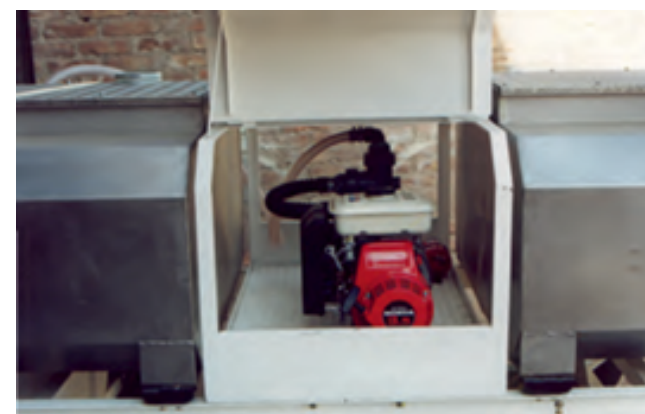
Alojamiento Motobomba Motor Pumps Box
